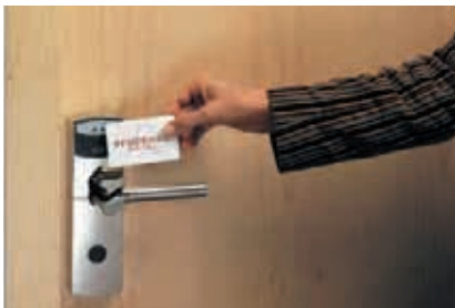
屋内扉アクセスコントロール
